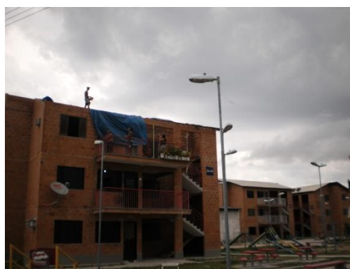
Figura 12: Destelhamento PRGM. Fonte: Meneghini, 2011.
