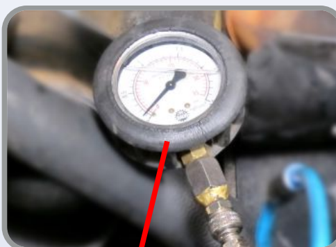
DETALHE DO MANÔMETRO ANTES DE PRESSURIZAR O SISTEMA DE AR
