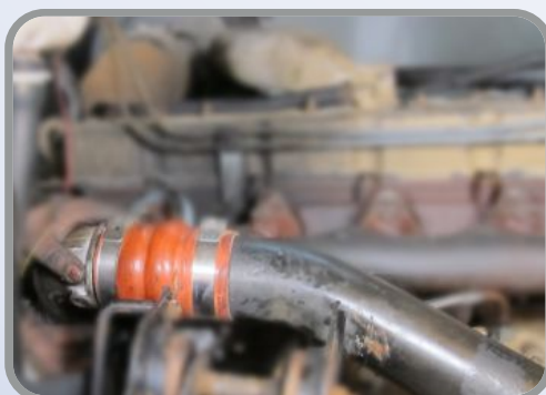
DETALHE DA MANGUEIRA DE SAÍDA DO INTERCOOLER
