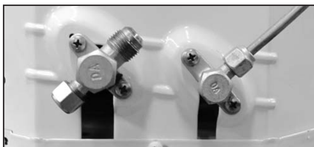
FIG. 32 - CONEXÃO DA LINHA DE EXPANSÃO DA UNIDADE CONDENSADORA
