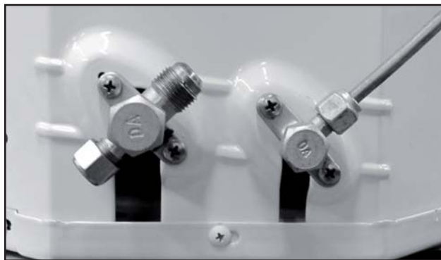
FIG. 39 - CONEXÃO DA LINHA DE EXPANSÃO DA UNIDADE CONDENSADORA
