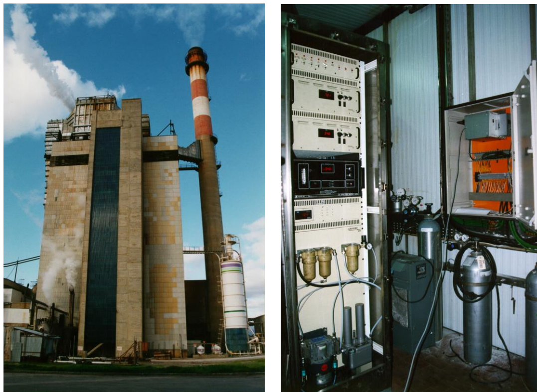
Fig. 2.1 – Fotografia da chaminé das caldeiras (CR e CA) e de um CEM
