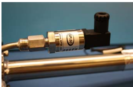
Figura B-20 Posicionamento do novo transdutor de pressão instalado
