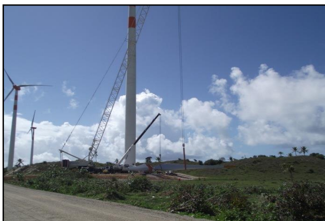
Figuras 2 e 3: Aerogeradores implantados no parque eólico da Barra dos Coqueiros
