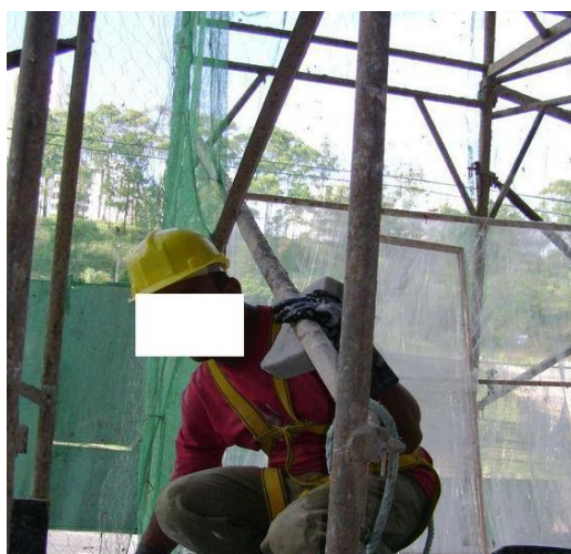
Figura 72 – Falta de espaço para assentamento de granito
