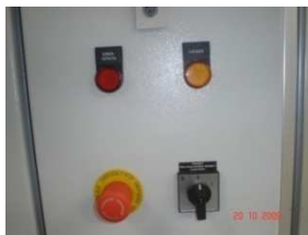
Figura 1 – Painel de potência
