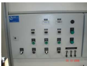
Figura 2 – Painel de comando
