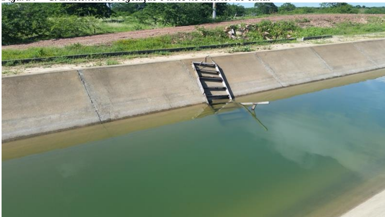
Figura 7 – C. Existência de vegetação e lixos no interior do canal
