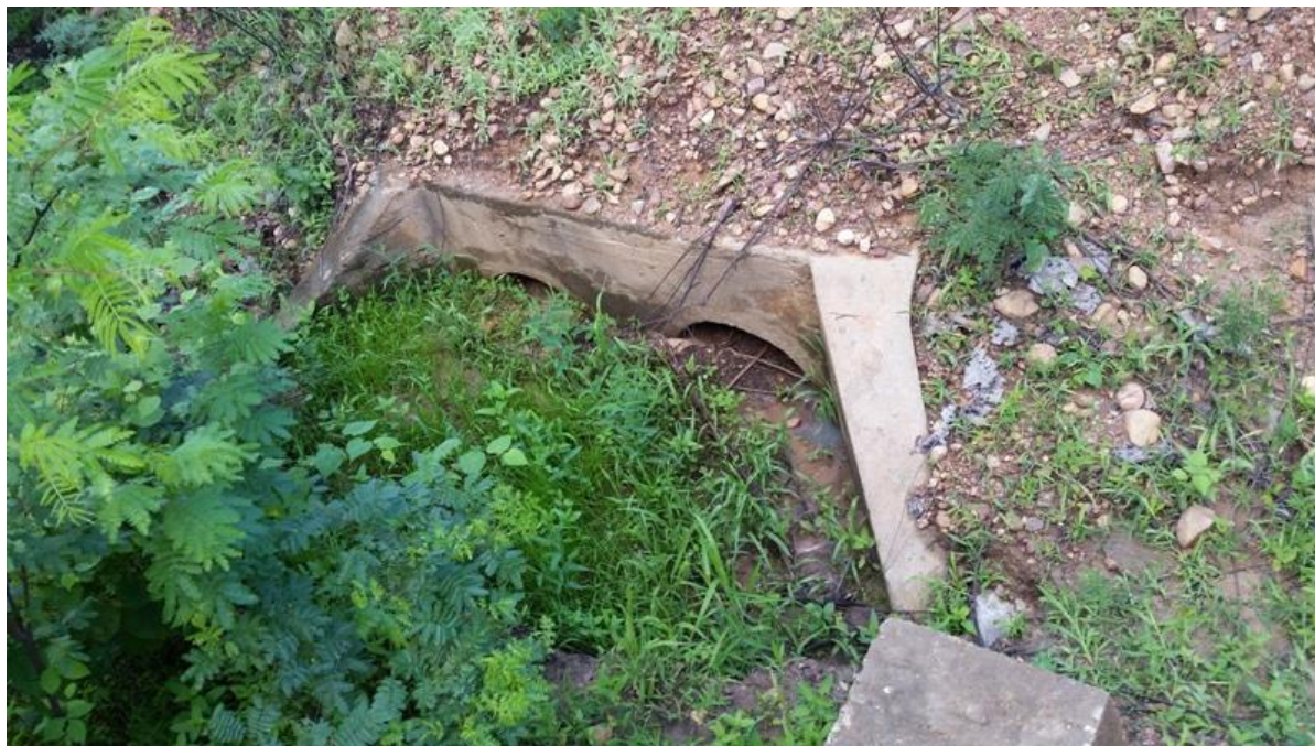
Figura 1 – A. Bueiros de estradas assoreados/obstruídos
