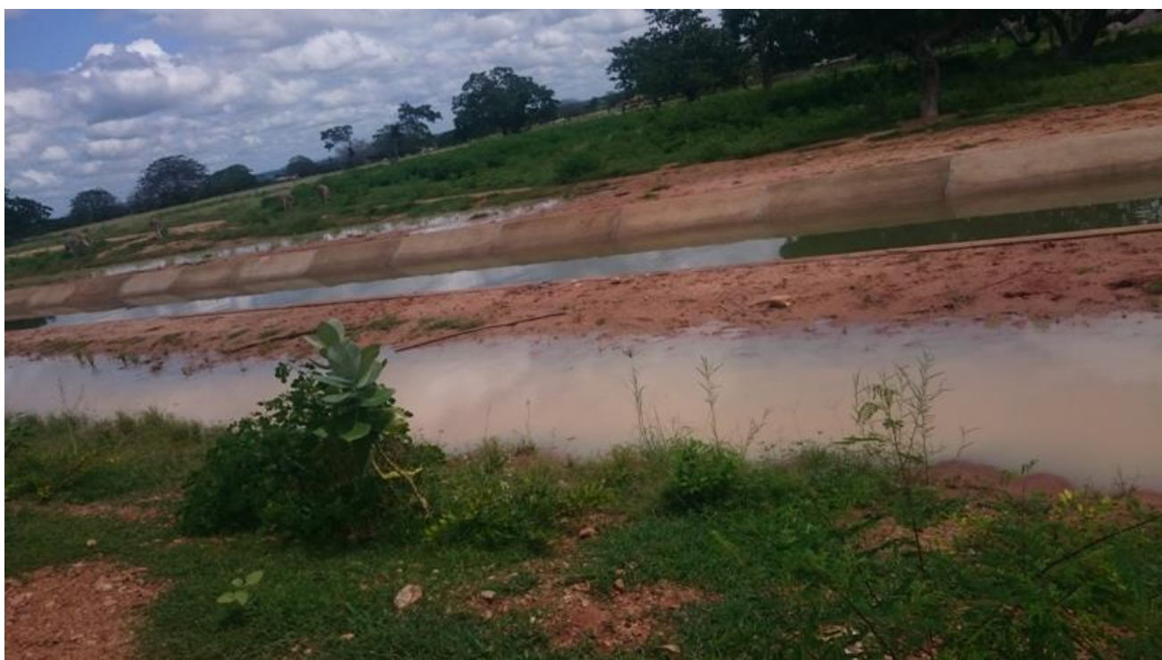
Figura 6 – B. Estradas de serviços com alagamento
