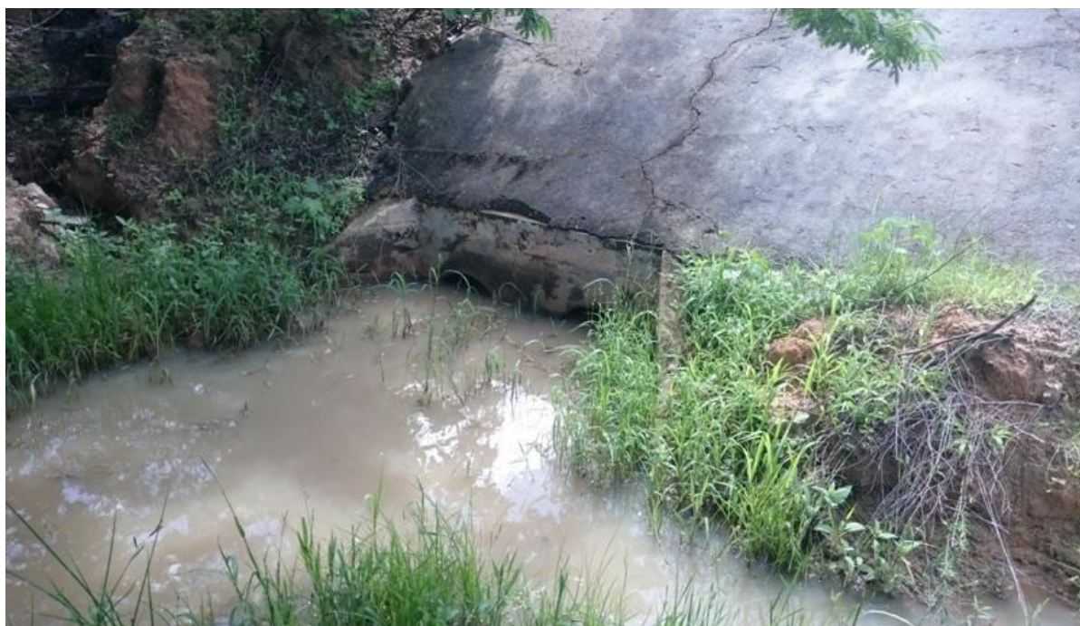
Figura 2 – A. Bueiros do sifão assoreados/obstruídos
