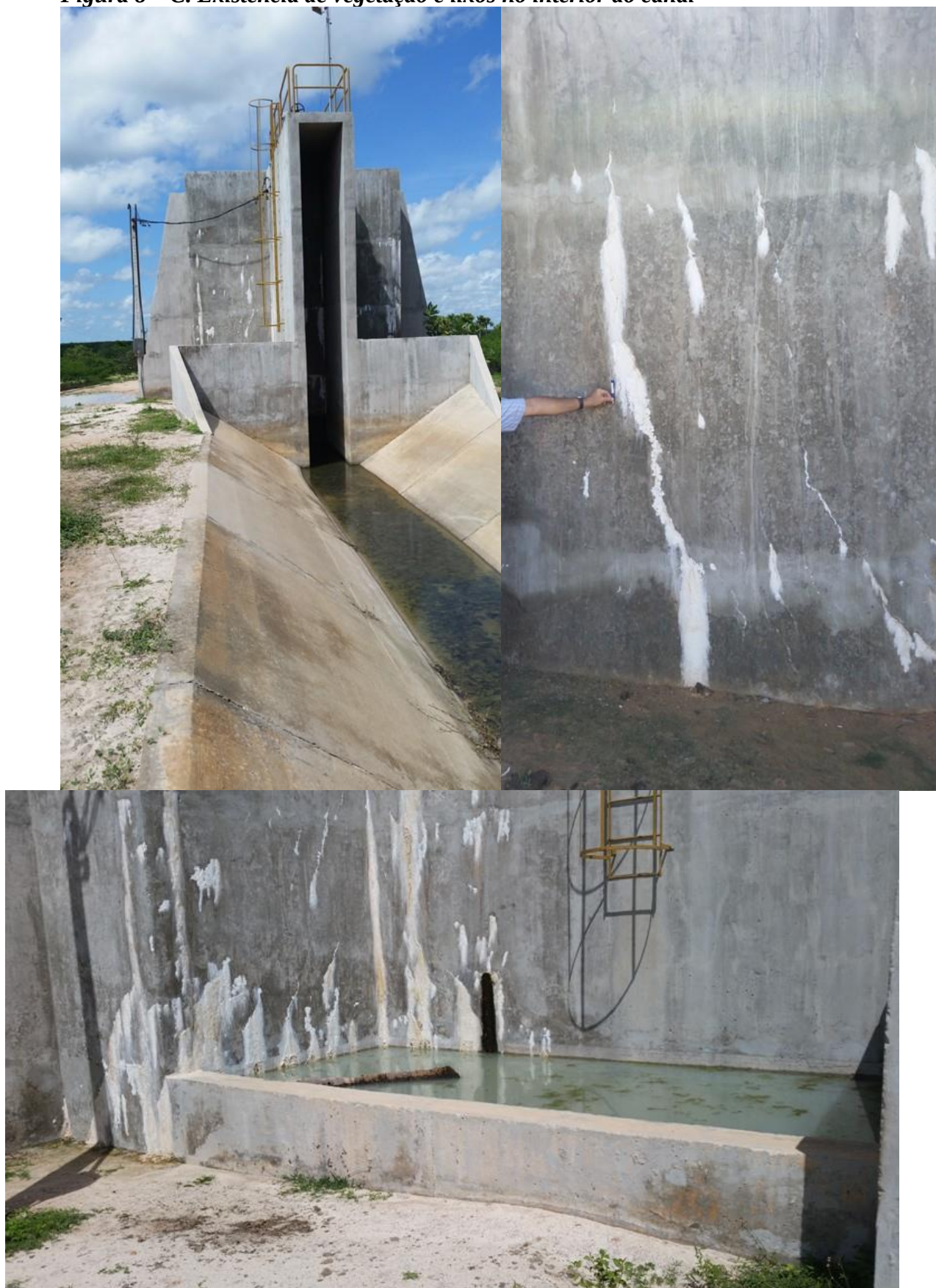
Figura 8 – C. Existência de vegetação e lixo no interior do canal
