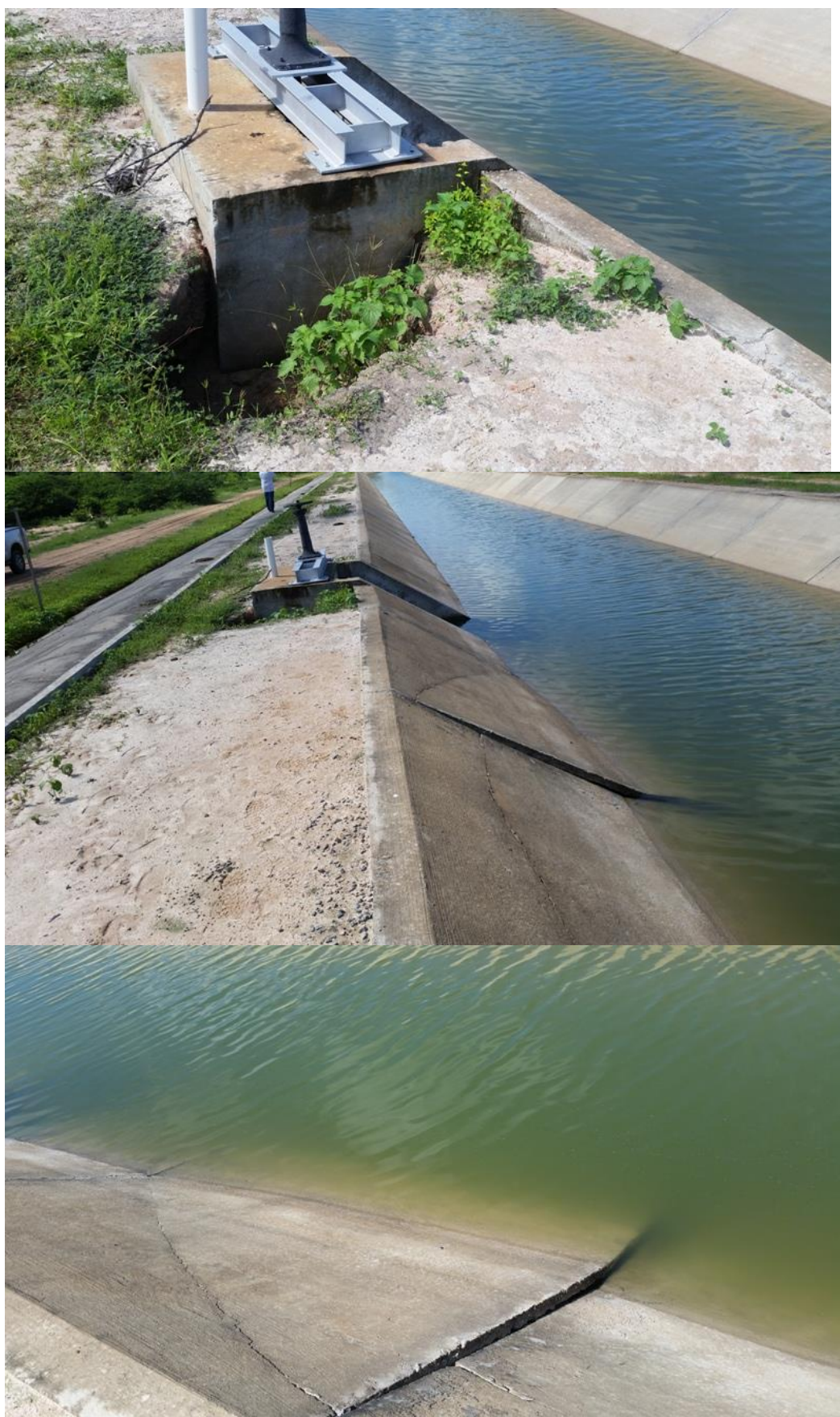
Figura 3 – B. Trincas e descolamento de placas de concreto: Tomada d'água T1.4.
