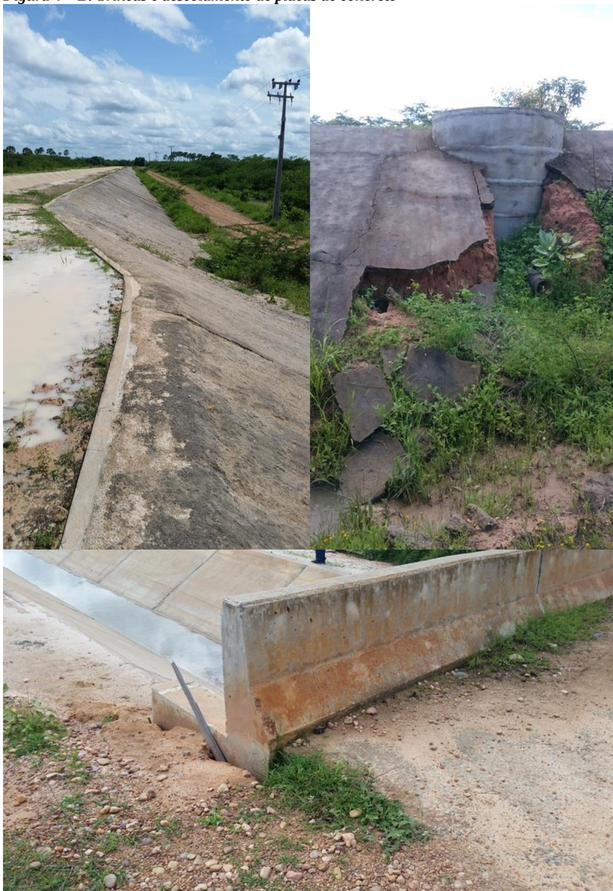
Figura 4 – B. Trincas e descolamento de placas de concreto
