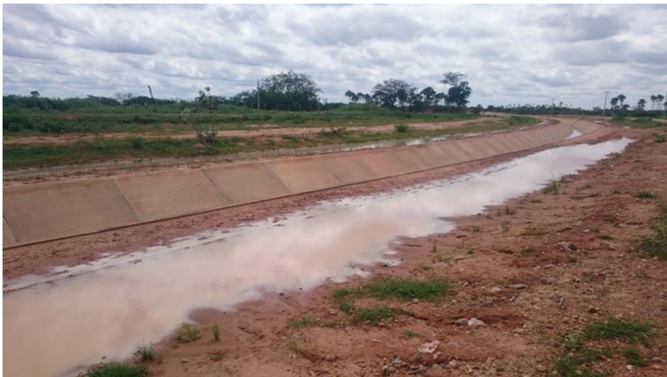
Figura 5 – B. Processos erosivos às margens do canal
