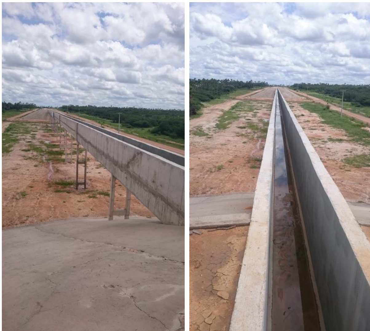
Figura 10 – E. Vazamento na junta de impermeabilização da ponte-canal
