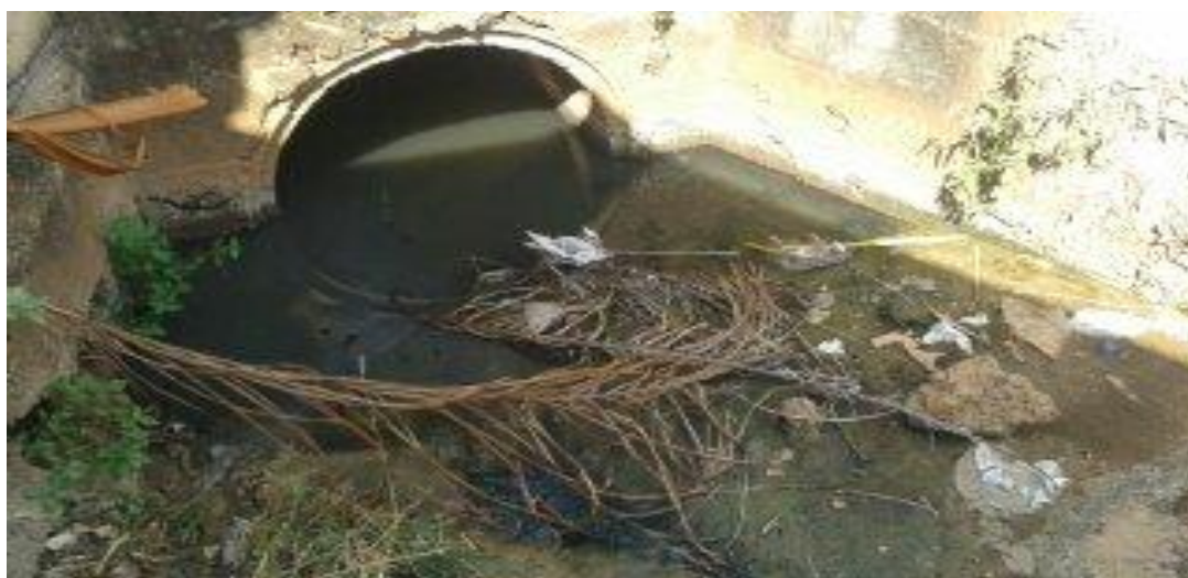
FIGURA 1. Rua 24, Emerêncio. Esgoto a céu aberto.
