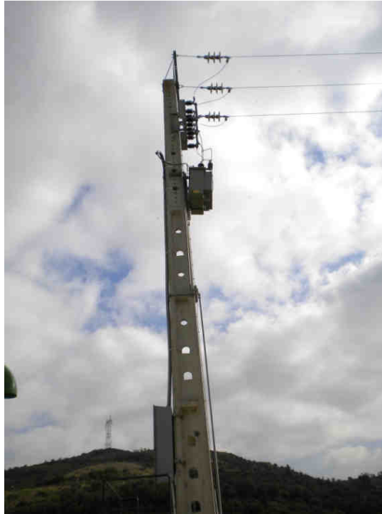
Figura 9 -Vista geral de um PTA do tipo AS.
