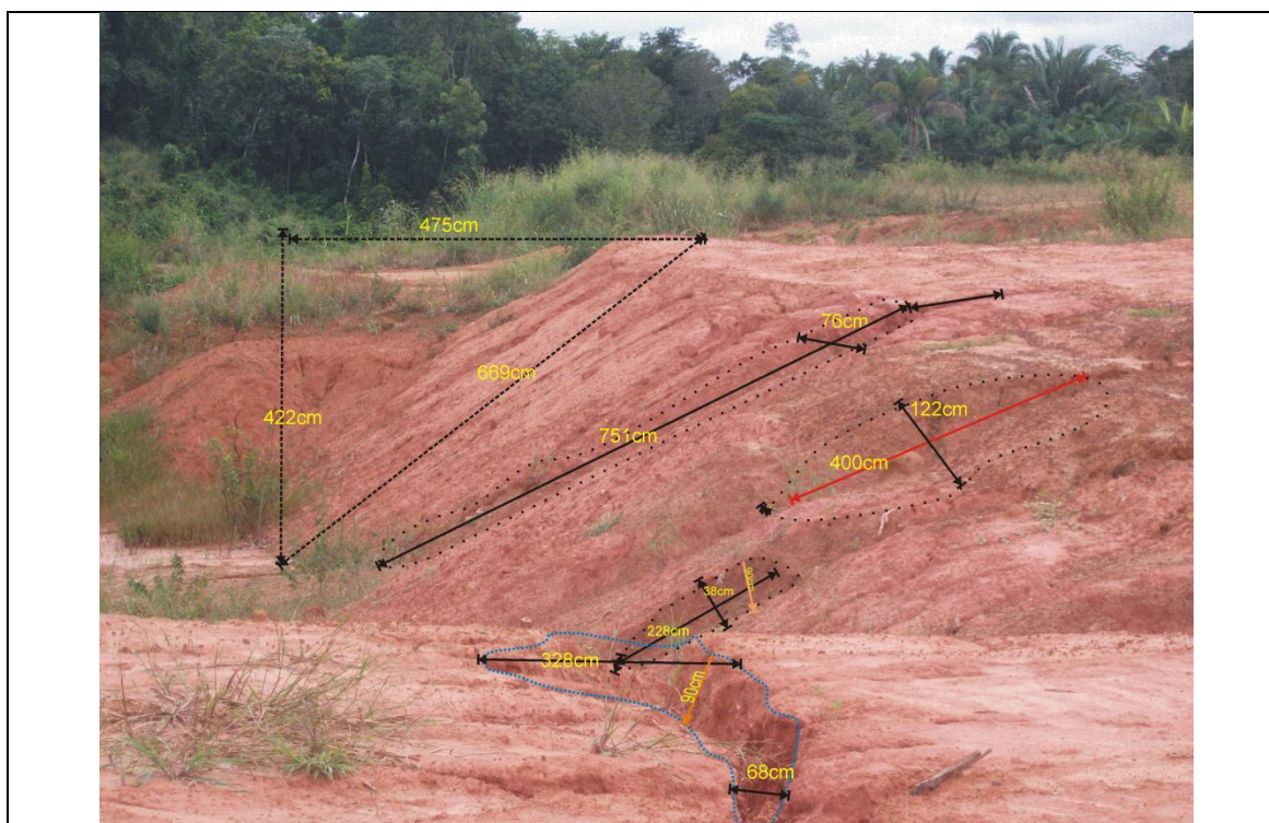
Figura 2. Detalhe da área 01 com pontos críticos com sulcos de erosão.
