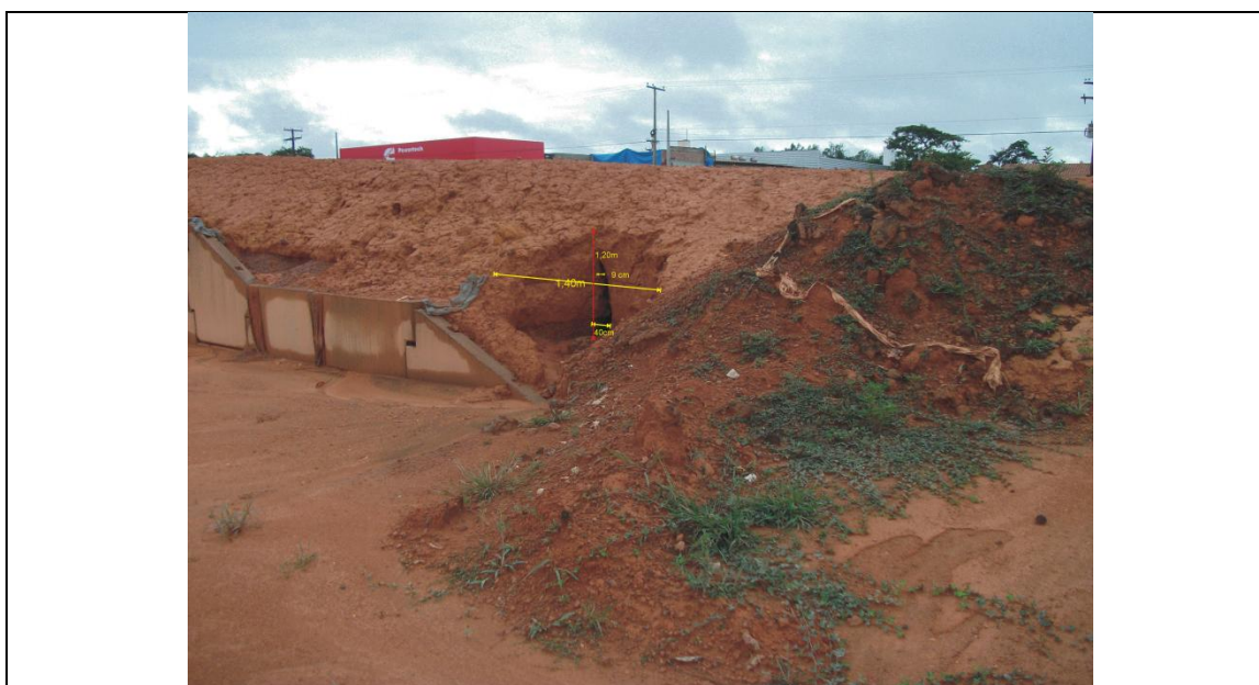
Figura 8. Detalhe da área 03 sob ação erosiva.
