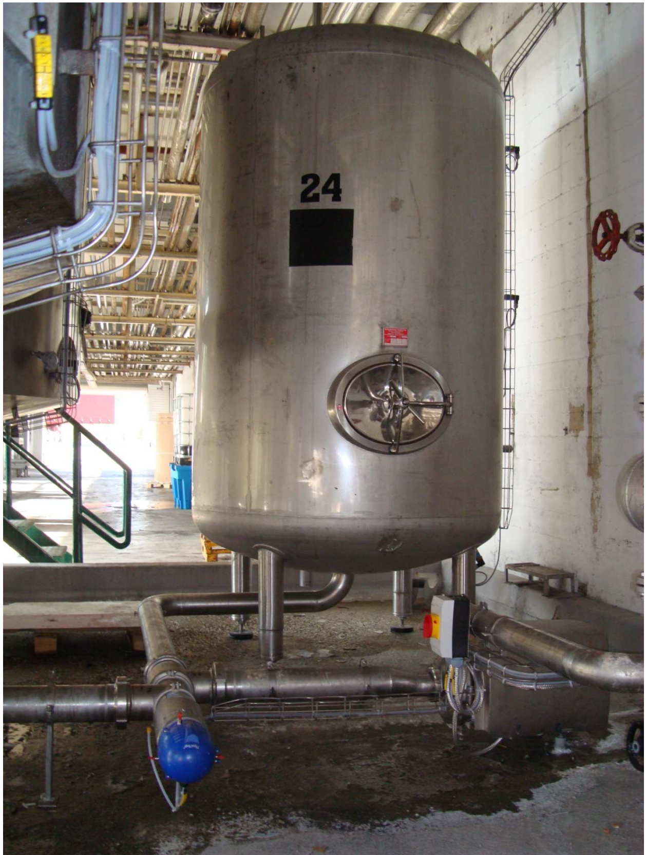
Figura A3.3 Tanque-pulmão – Instalação CIP
