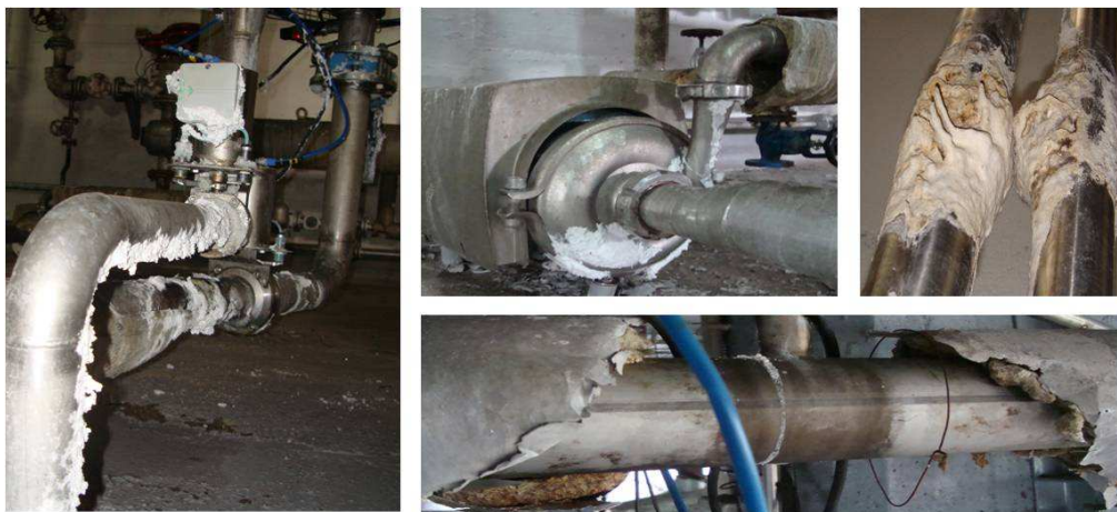
Figura 3.9 Exemplos de não conformidades na instalação CIP – Linha 3
