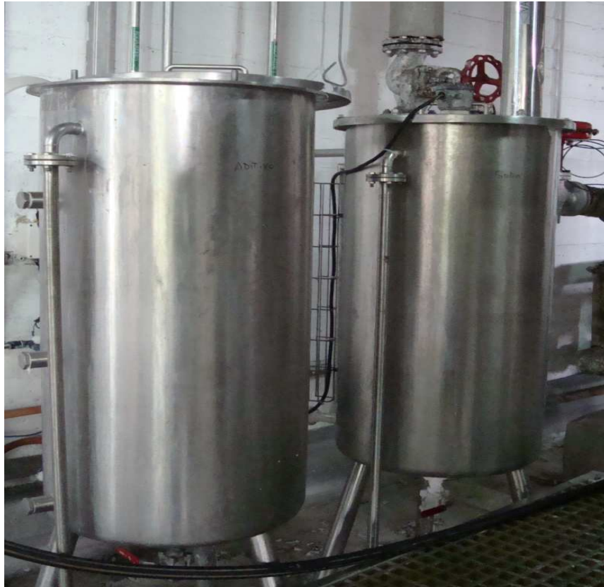
Figura A3.1 Tanques intermédios de detergente e de aditivo – Instalação CIP
