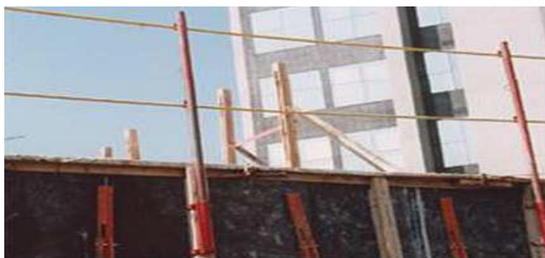
Figura 2: Guarda corpo de laje
