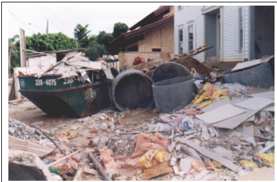
Figura 26: Desperdício de material em obra feita com a técnica de construção a seco, empregando chapas de gesso acartonado. Fonte: Autor. Florianópolis, 1999.
