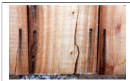
Figura 64: Rachadura decorrente da utilização de tábua com alto teor de umidade. Fonte: Autor 2001.
