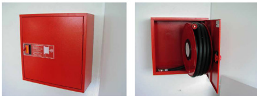
Fig.5.11 – Boca-de-incêndio tipo carretel existente no lar.
