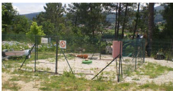
Fig.5.8 – Reservatório de Gás enterrado.
