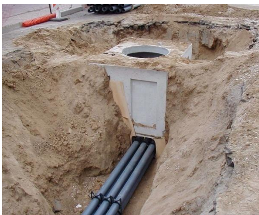
Figura 36 – Fotografia de uma vala técnica com a interligação de tubagens numa câmara de visita
