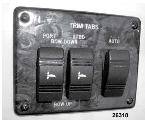
Interruptores típicos de compensadores com cancelamento automático
