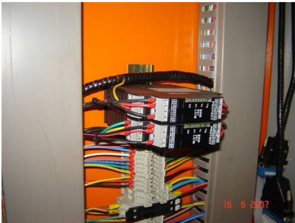
PLC – RELÉ DE SEGURANÇA NÍVEL 4
