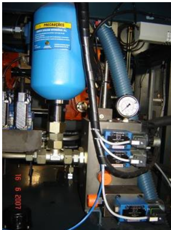
VÁLVULA DE PROTEÇÃO HIDRÁULICA
