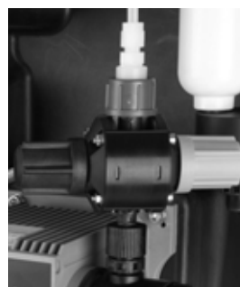
Fig. 42 Válvula multifunções na bomba doseadora
