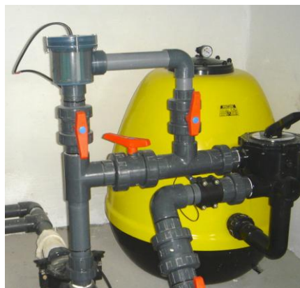
Instalação em "bypass".
