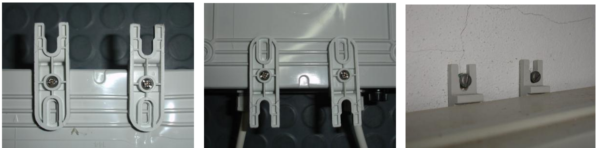
Fixações do Quadro Eléctrico do Hidrion à parede.
