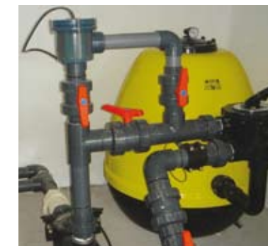
Instalação em “bypass”
