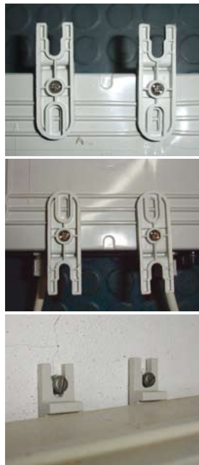
Fixações do Quadro Eléctrico do HIDRION à parede
