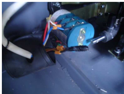
Figura 1 – Chave seletora fixada no interior da máquina.
