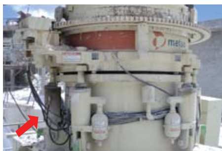
Dano às vedações dos cilindros devido ao desalinhamento da haste.
