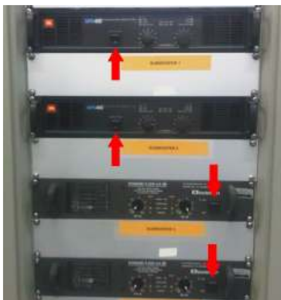
Figura 20 – 4 dos 13 amplificadores, com a indicação dos botões que os ligam (estes da foto estão localizados no rack 4). Note que dos 4 acima, temos dois pares diferentes. Apenas os dois de baixo são de marca diferente, e todos os outros 9, que não estão na foto, são ligados como os dois de cima.
