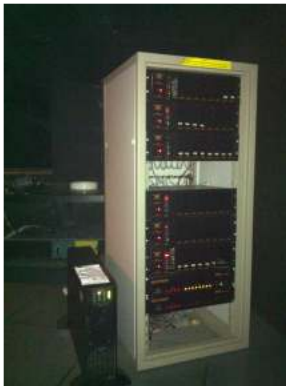
Figura 22 – Rack localizado na sala dos projetores. À esquerda dele está localizado o no break que deve ser ligado.
