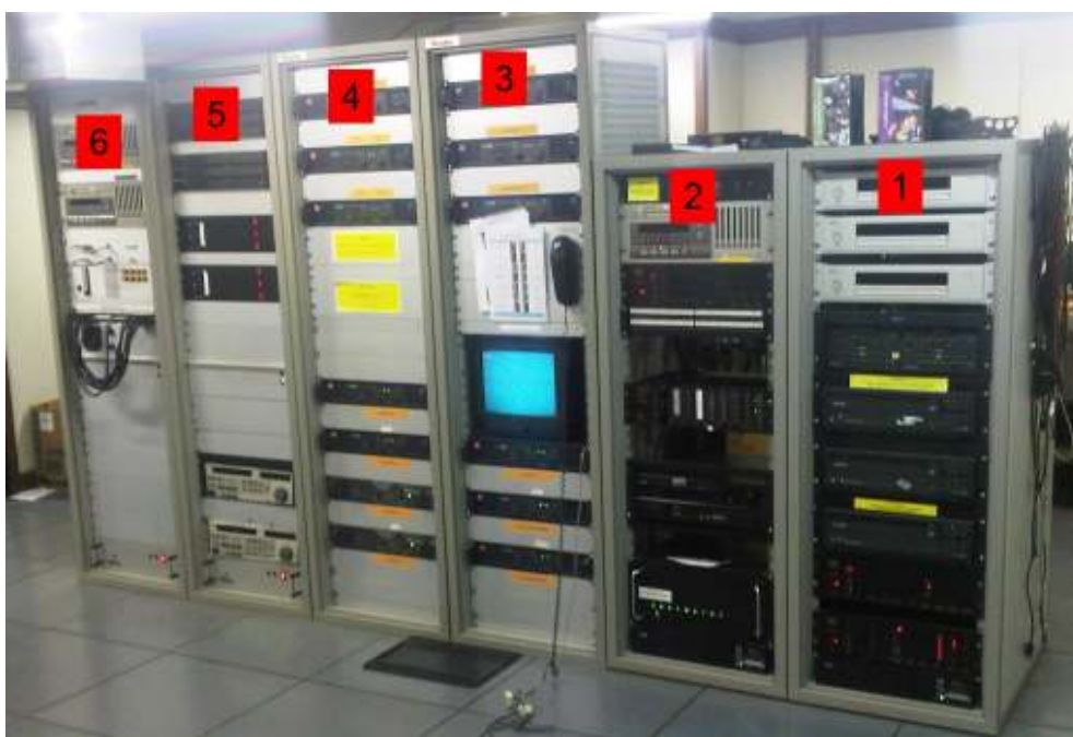
Figura 13 – Racks de equipamentos identificados de 1 a 6, da direita para a esquerda.
