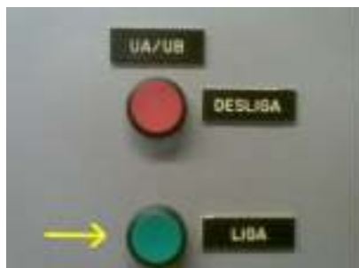
Figura 9 – Botão que deve ser pressionado no armário 4.
