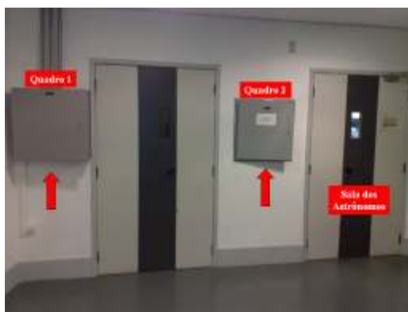
Figura 2 - Setas indicando os quadros de disjuntores que devem ser ligados e a sala dos astrônomos.
