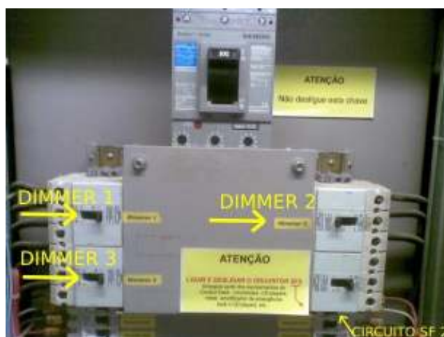
Figura 8 – Indicação dos disjuntores que devem ser ligados no armário 3.
