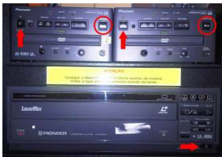
Figura 155 – Identificação dos equipamentos a serem ligados do rack 1, e os botões de Liga/Desliga.
