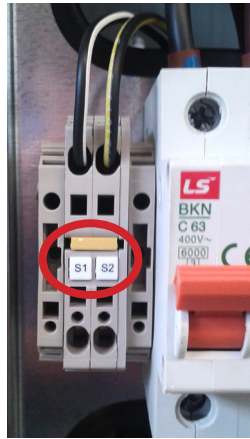
Figura 9: Terminação de ligação do transformador de corrente (TC)
