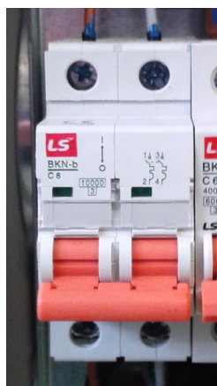
Figura 11: Magnetotérmico bipolar do circuito de alimentação do regulador.
