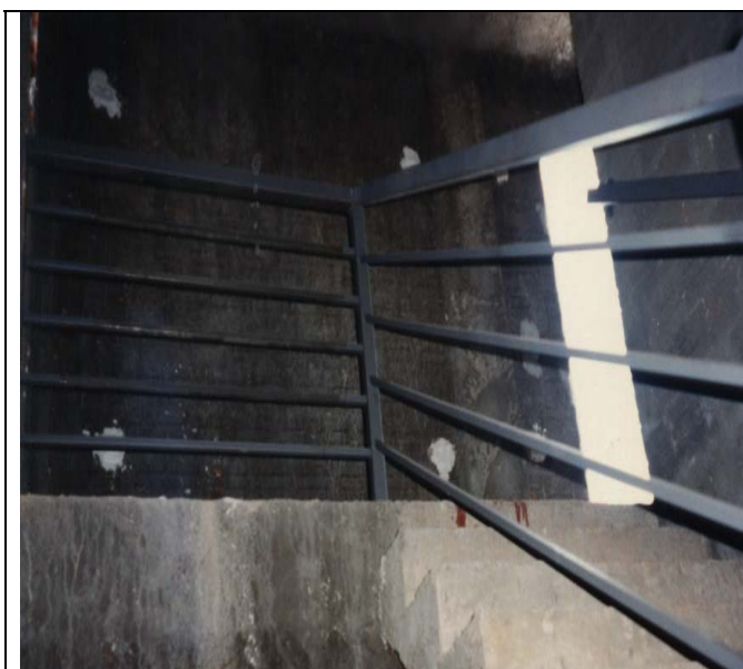
Figura 35 - Corrimão metálico definitivo em escada enclausurada
