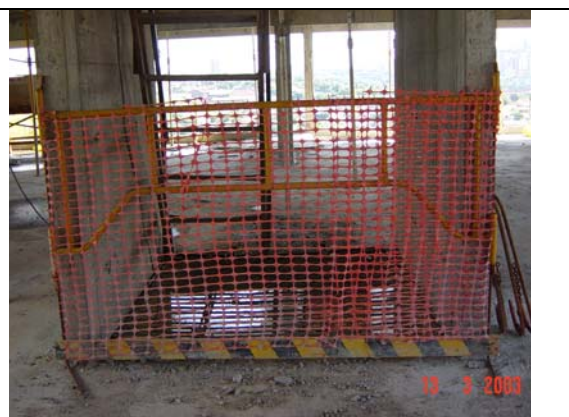
Figura 42 – Proteções em abertura de piso no poço do elevador
