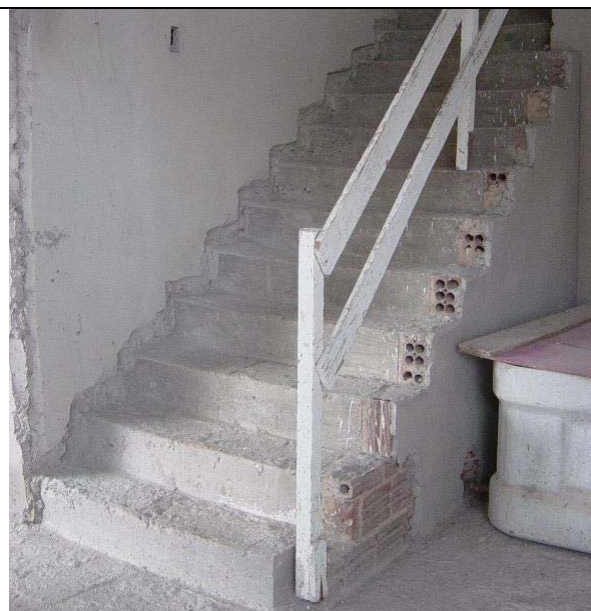
Figura 38 – Proteção lateral e corrimão fora de norma
