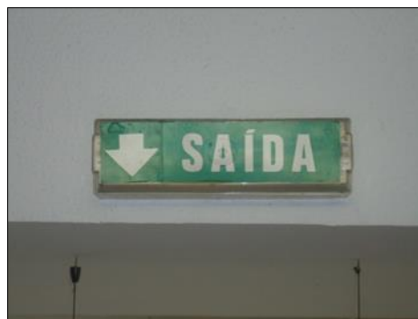
Figura 16: Sinalização de saída de emergência desatualizada.
