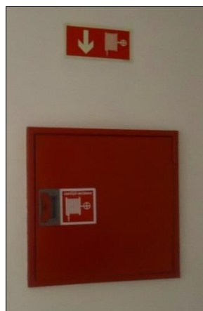
Figura 6: Carretel de incêndio.
