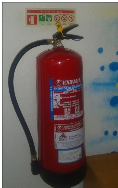
Figura 19: Extintor de água (9L) que existe na sala Infante/Juvenil.
