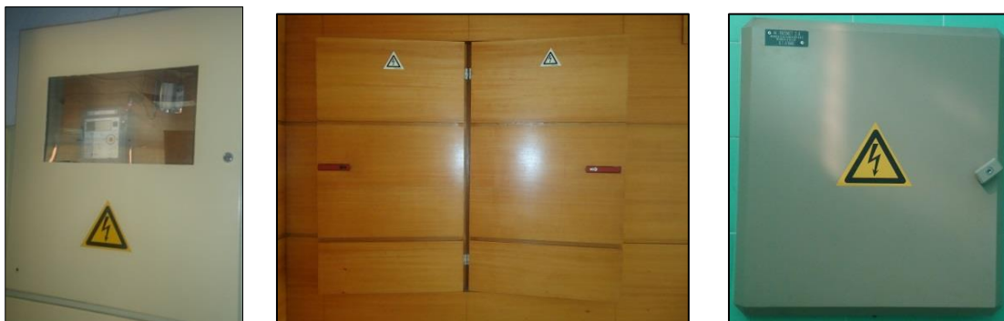
Figura 1: Quadros elétricos (da esquerda para a direita: geral, auditório e cafetaria).
