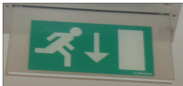
Figura 17: Sinalização de saída de emergência atualizada.
