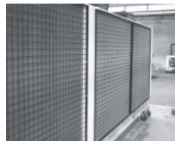
Protecções da bateria do condensador
