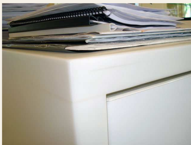
Exemplo de emenda mal executada.
