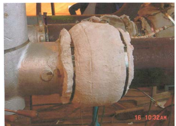
Detalhe do isolamento térmico das resistências.
