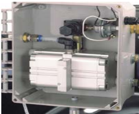
Figura 20. Caixa de controlo
