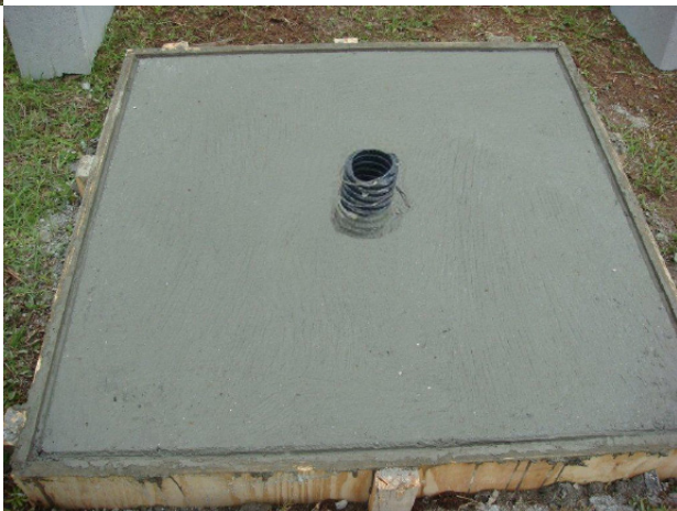
Figura 3 - Base de concreto com duto para passagem de cabos
