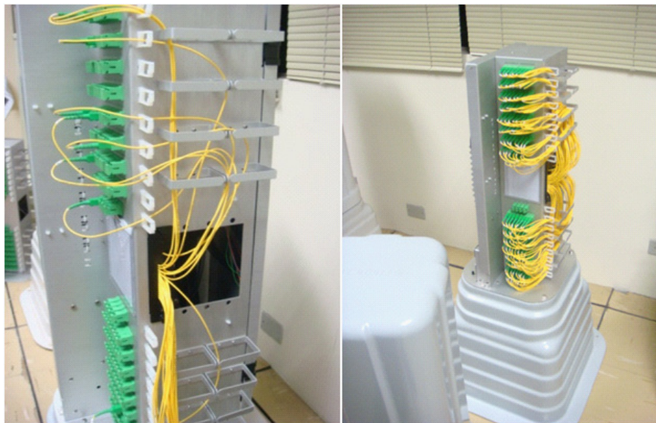
Figura 13 - Acomodação dos cordões do splitter
