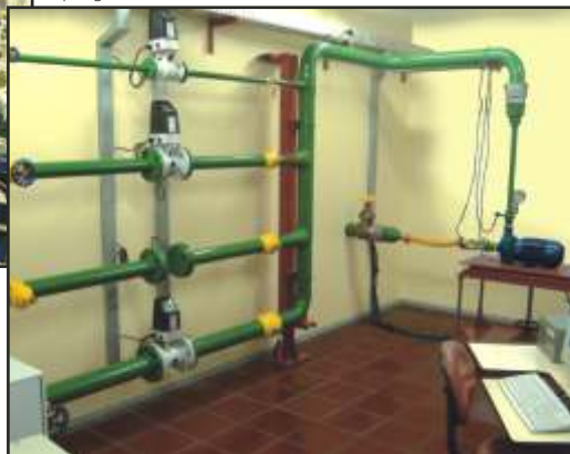
Vista parcial das instalações de produção e do laboratório de desenvolvimento de bombas hidráulicas.
