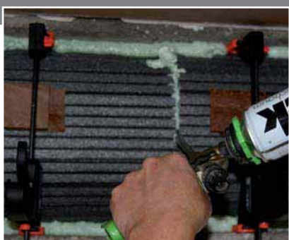
10 Coloque espuma PU também entre placas FLEXOTERM, assim como nos espaços entre a placa de isolamento e a parede.
