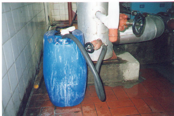
Figura 03 – Procedimento de Drenagem de Óleo Totalmente Inadequado (L. Tomaz Cleto – Banco de Imagens – Arquivo Pessoal).
