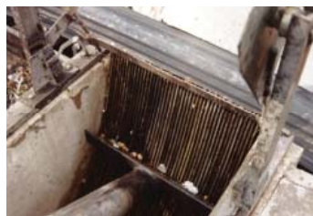
Grade de limpeza mecanizada
