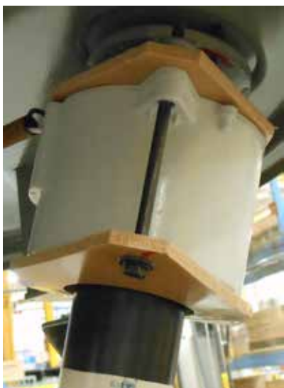
Figura 18. Transformador de corrente interno montado na bucha.
