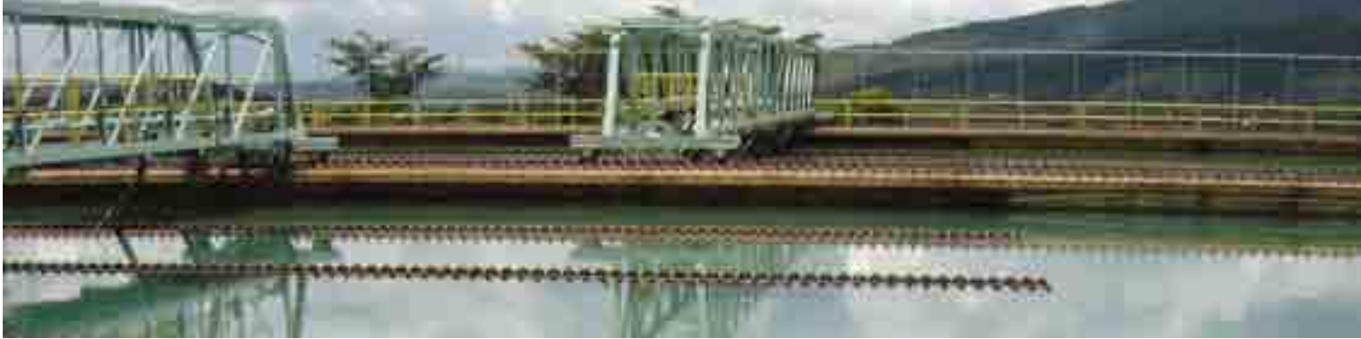
Decantador com ponte rolante com raspador
