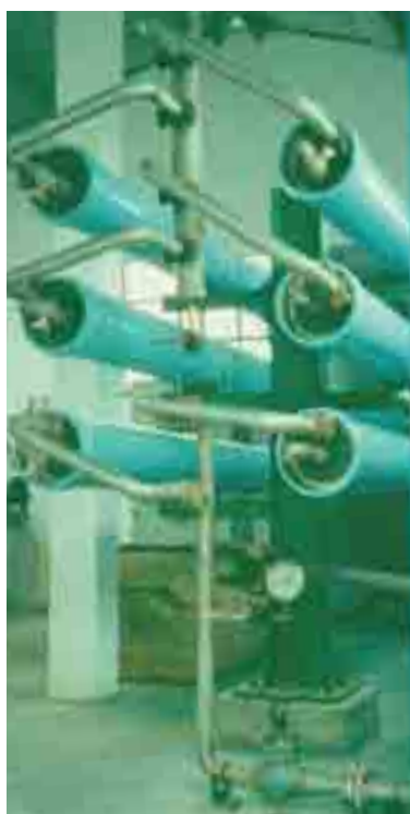
Filtração em membranas
