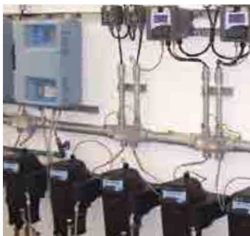
Equipamentos de medição de pH, turbidez e vazão da água filtrada
