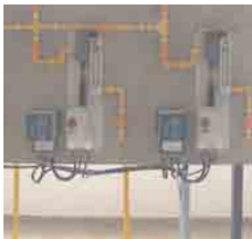
Dosadores de cloro
