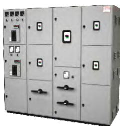
Centro de Distribuição BT
