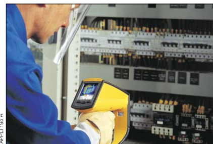
Inspeção de quadros eléctricos
