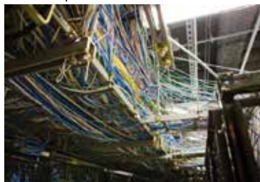
FIGURA 5 – Instalação inadequada da rede.
