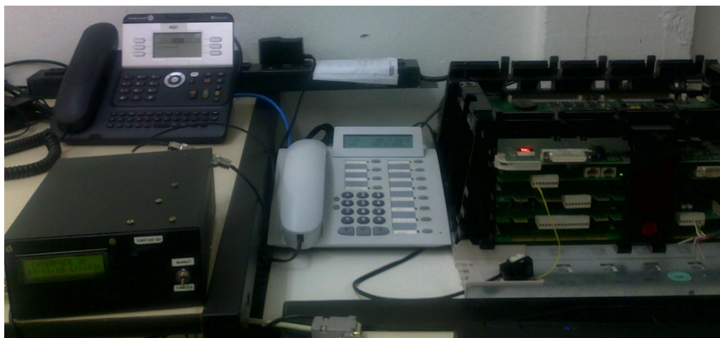
Figura 4-71 – Fotografia do dispositivo instalado em ambiente de produção
