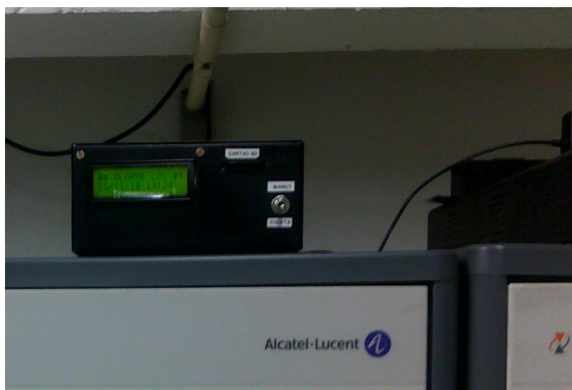
Figura 4-66 – Fotografia do dispositivo instalado em ambiente de produção
