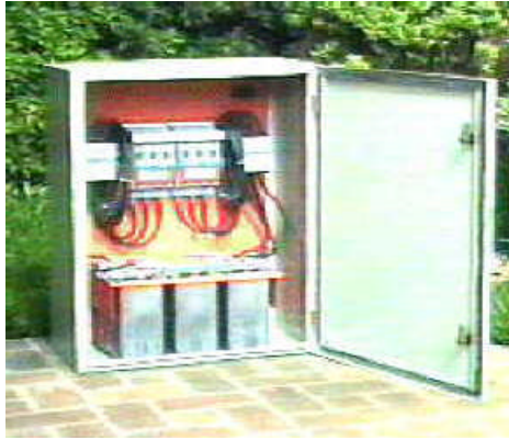
Figura 4.12 - Quadro de comando de capacitores.
