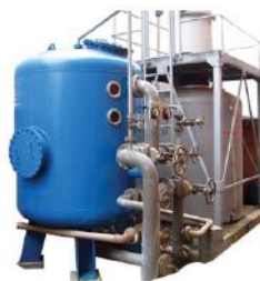
Sistema composto por Aerador e Filtro de Areia.
