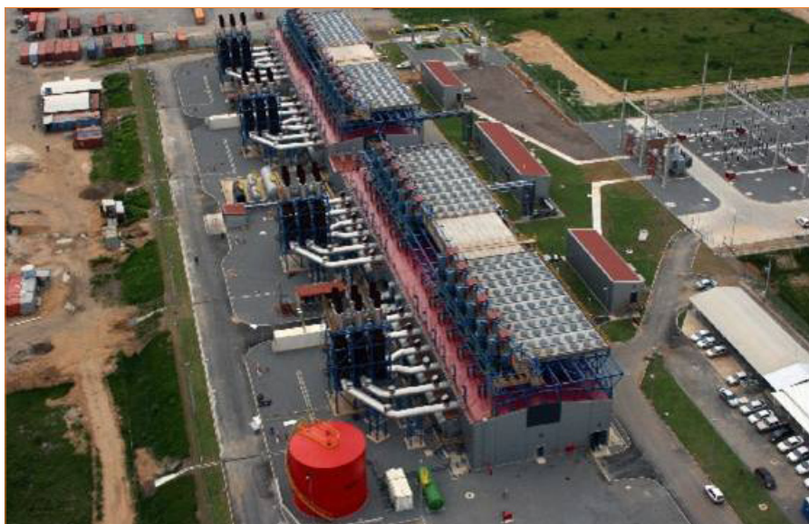
F1. Subestação da Usina Termelétrica de Linhares (ES).
