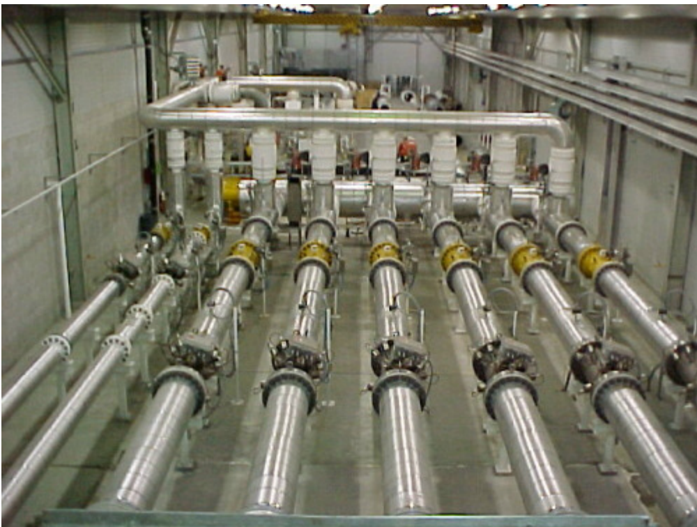
Laboratório de Calibração de Vazão
