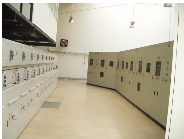
Figura 1- Posto de transformação do HSMaria
