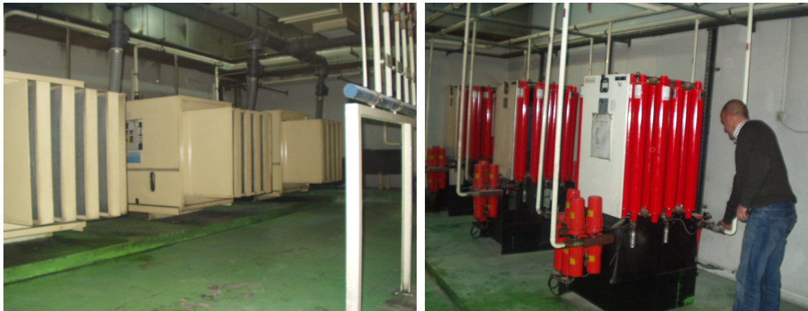
Figura 3- Central produtora de ar comprimido medicinal
