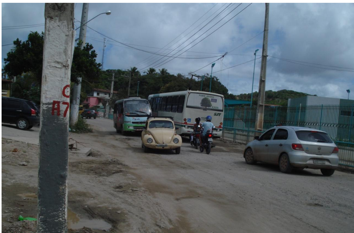
Foto 8: Precárias condições da rodovia PE 028 no trecho que corta Gaibu. Fonte: Adauto Gomes, ago / 2013.
